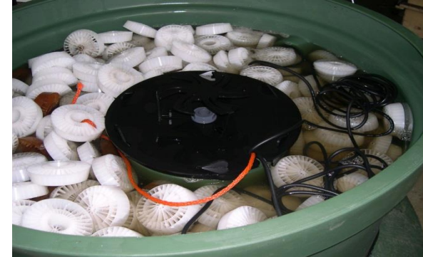
Jäteveden puhdistus, säiliöt ja suodattimet kiinteille, nestemäisille ja kaasumaisille jätteille (Kuva: Timo Laaksonen)
